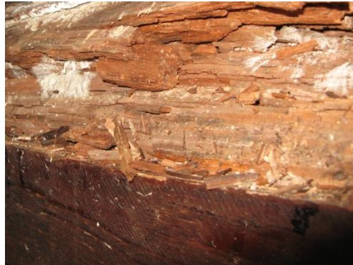
Figura 6. Madera con aspecto que semeja un material fibroso, fractura con facilidad y con una significativa pérdida de peso. (Fuente: Blog símbolo calidad, 2014).
